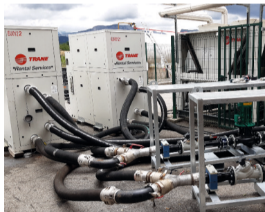
Saint Jean, ein französischer Teigwarenhersteller, kompensiert die Kesselheizung durch Wärmepumpen und senkt so die Heizkosten und den CO 2 -Ausstoß. Bild: Trane
