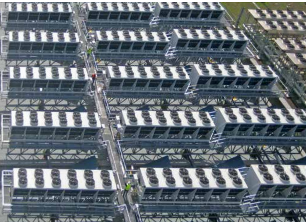
Rückkühler auf dem Dach des Inselelhospitals in Bern.
