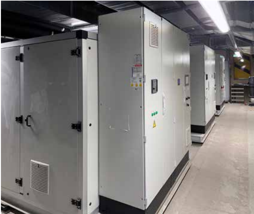
Blick in die Kältezentrale im Krankenhaus in Nagold
