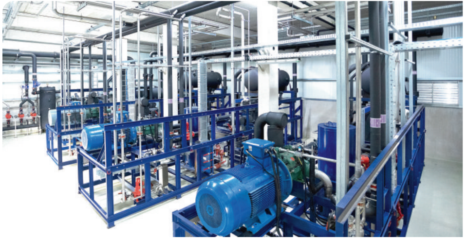
Kältezentrale mit Ammoniak-Kälteanlagen beim Fleischwarenhersteller Sutter GmbH in Gau-Bickelheim. Foto: Bitzer
