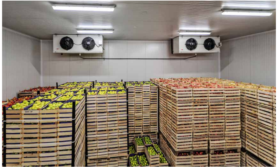
Auch in CA-Lagern für die Apfelernte kommen Kältemittel zum Einsatz.
